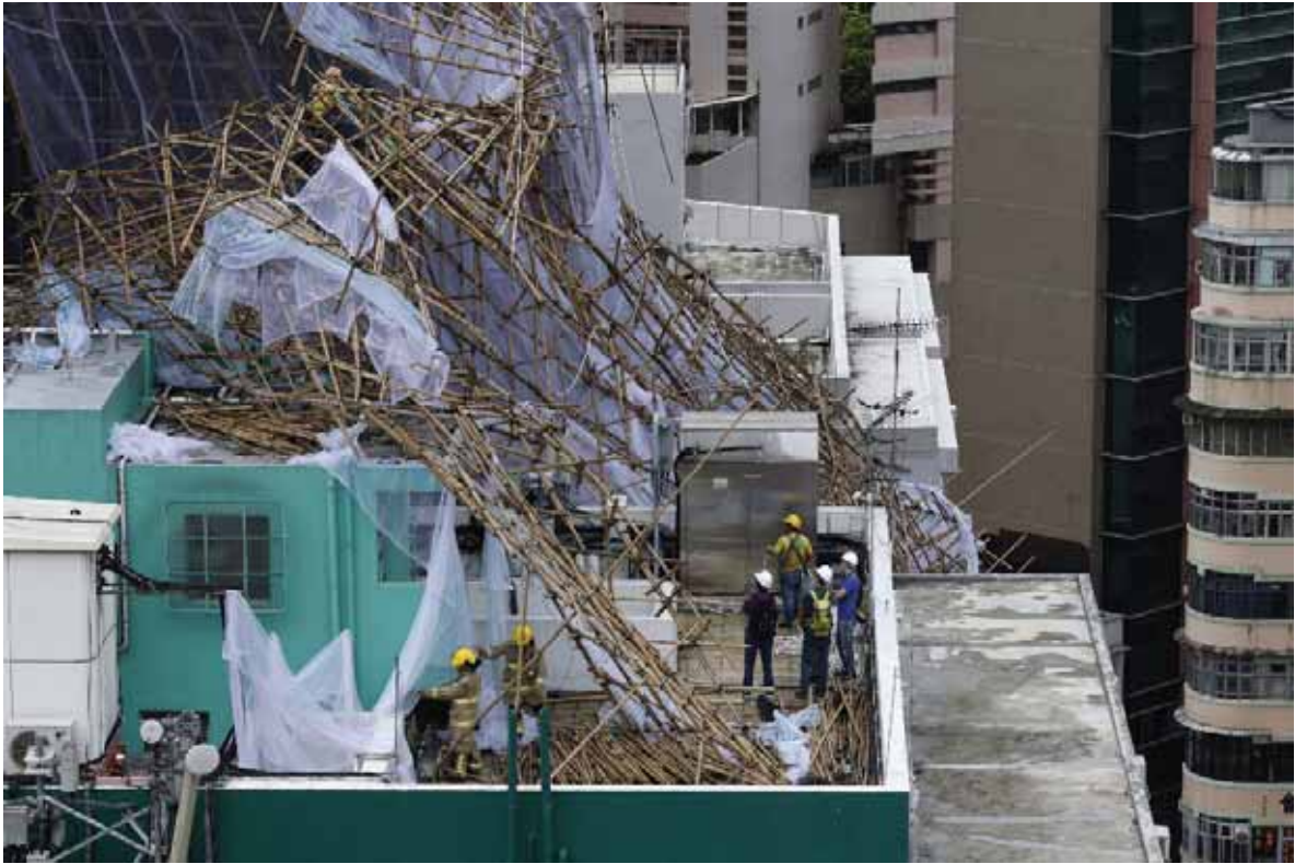
圖 2.2.8 灣仔菲林明道一幢商業大廈外牆一幅棚架倒塌。(相片由中國日報提供)
