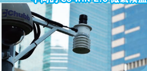
安裝在燈柱上的微氣候監測儀器
