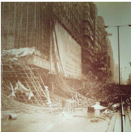
(a) 彌敦道的倒塌棚架
