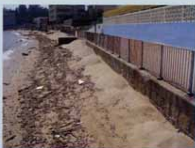
2008年，颱風黑格比引致的風暴潮侵蝕長洲海灘
