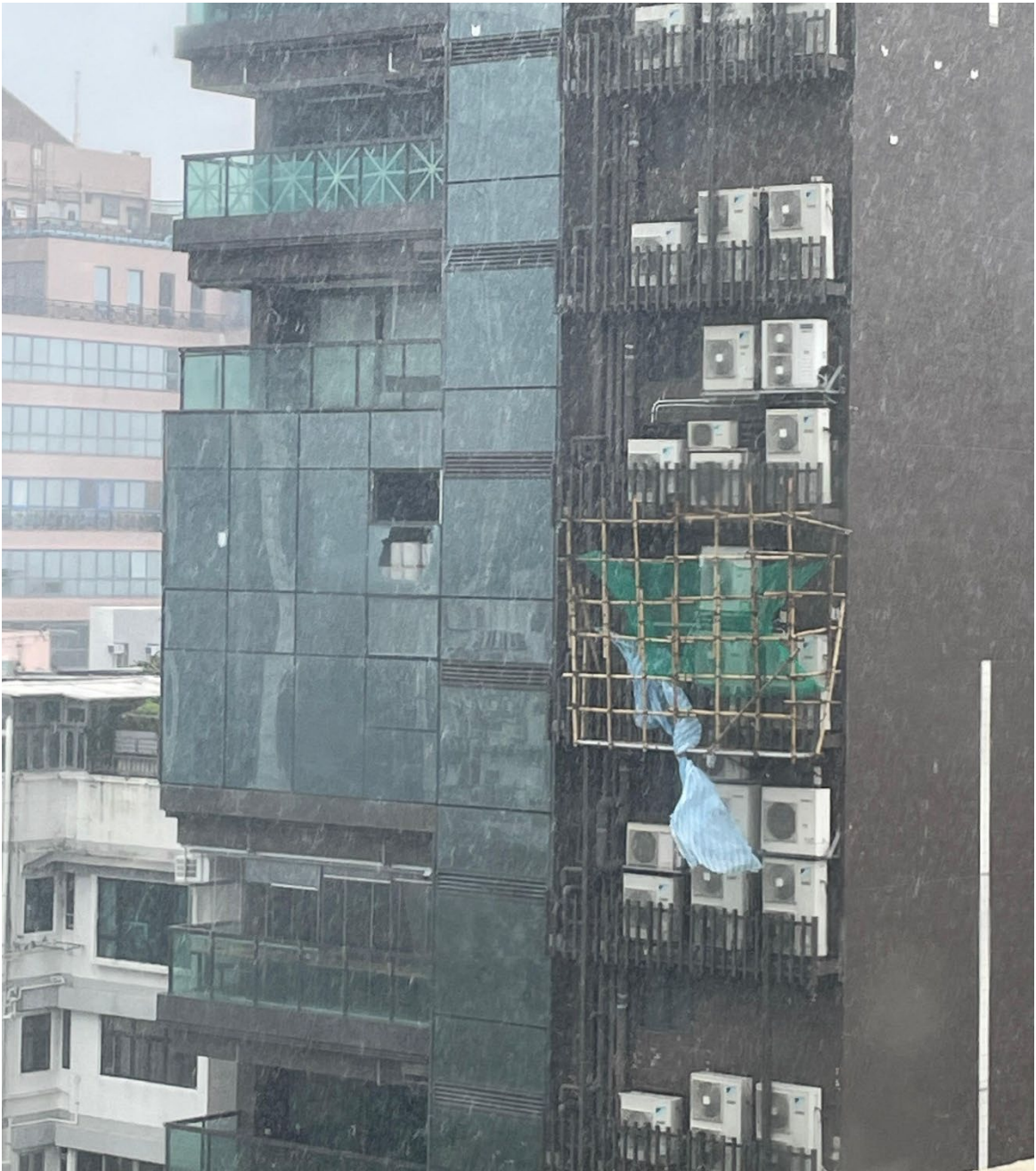
圖 3.11.17 樺加沙襲港期間，尖沙咀有大廈的玻璃幕牆受損。(鳴謝：呂旭昇)
