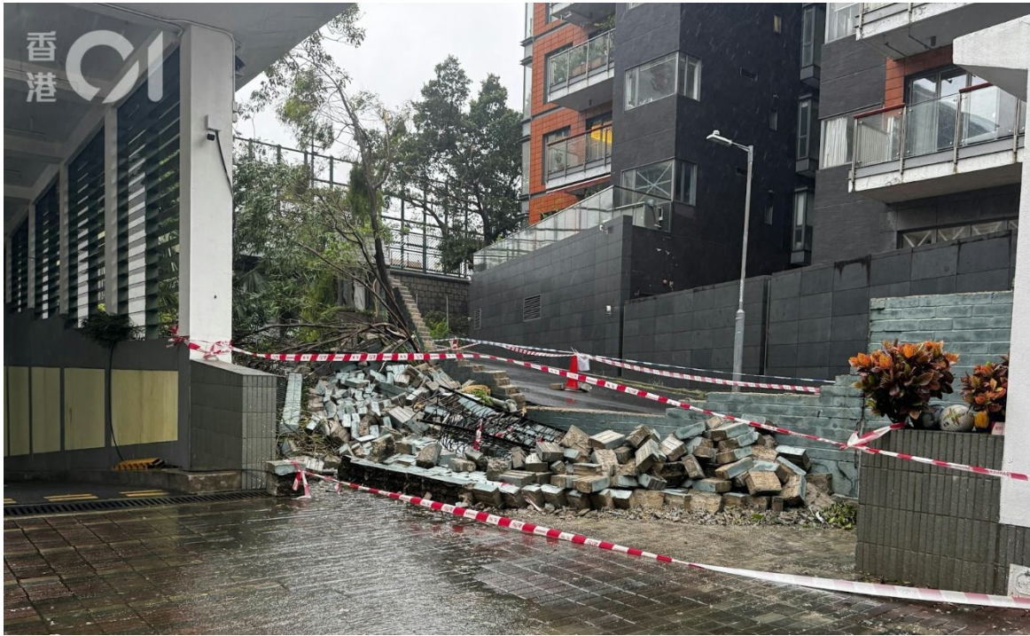
圖 3.11.15 樺加沙襲港期間，九龍塘有小學的圍牆倒塌。(鳴謝：香港01 / 林振華攝)
