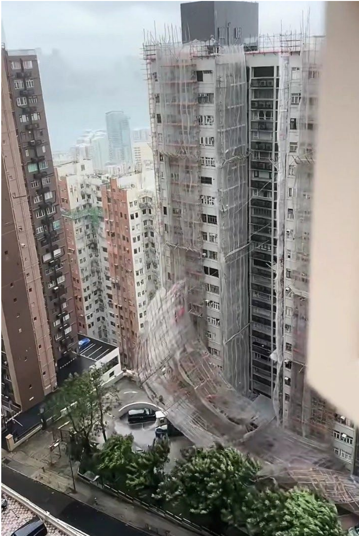
圖 3.4.12 韋帕襲港期間，北角有大廈一幅40米乘10米的外牆棚架倒塌，壓到屋苑內多輛停泊車輛。(鳴謝：Bruce Li)
