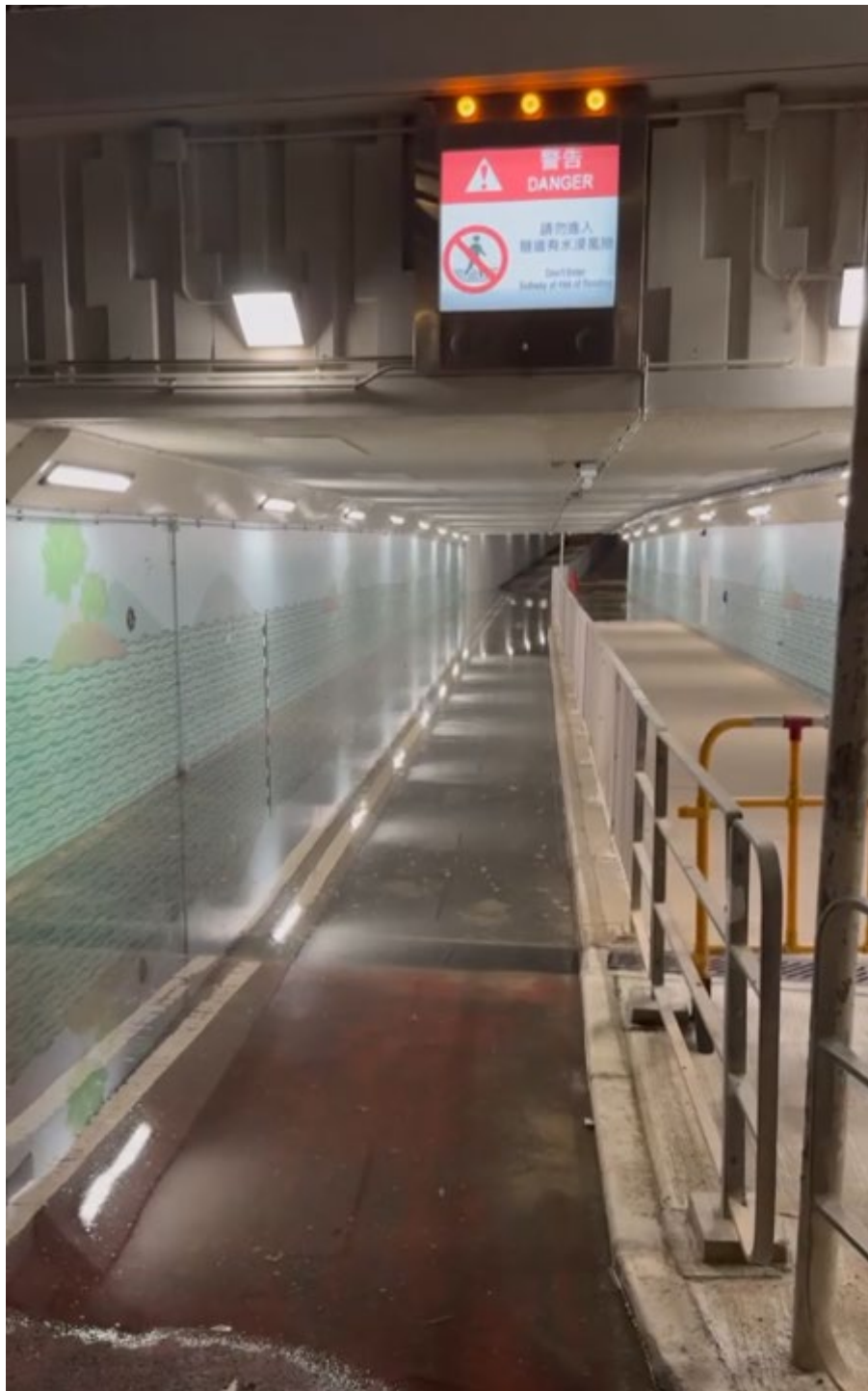
圖 3.13.5 二零二五年十月二十一日晚上沙田城門河旁的隧道出現輕微水浸。 (鳴謝：Eric Cheng)
