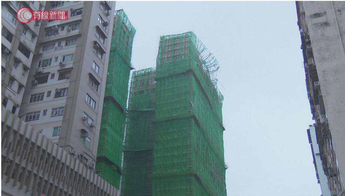
圖 3.11.14 樺加沙襲港期間，何文田窩打老道有大廈頂層一幅面積20米乘30米的外牆棚架受損，附近六條行車線需要封閉。(鳴謝：有線新聞)
