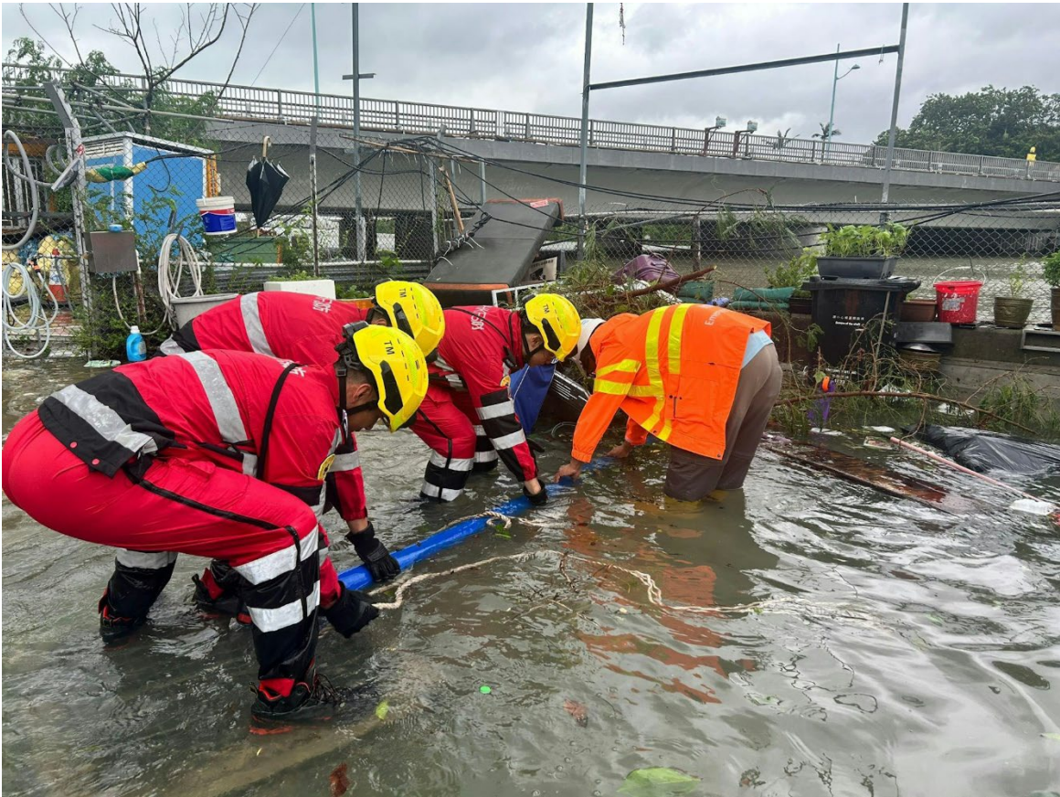
圖 3.11.22 受樺加沙引致的風暴潮影響，屯門嘉和里水位明顯上升，造成水浸。(鳴謝：渠務署)
