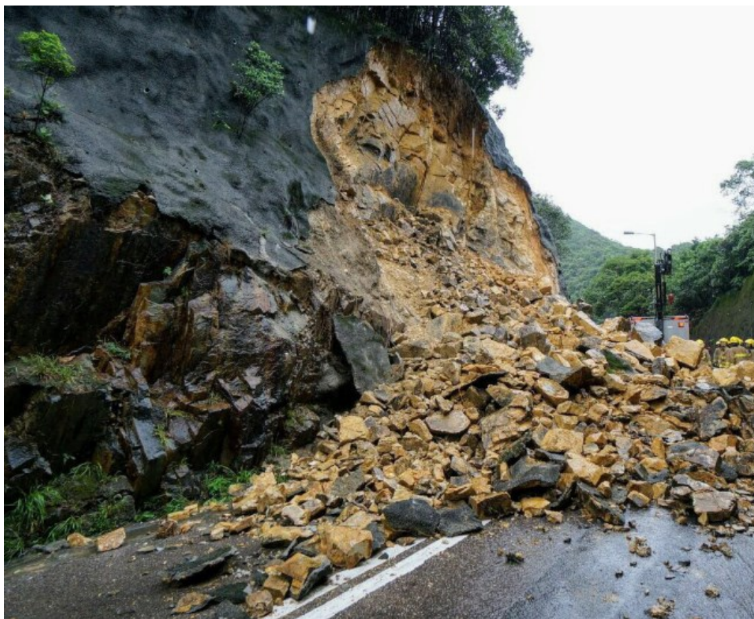
圖 2.2.7 柱大潭道一幅護土牆在暴雨下倒塌(照片由土力工程處及土木工程拓展署提供)。
